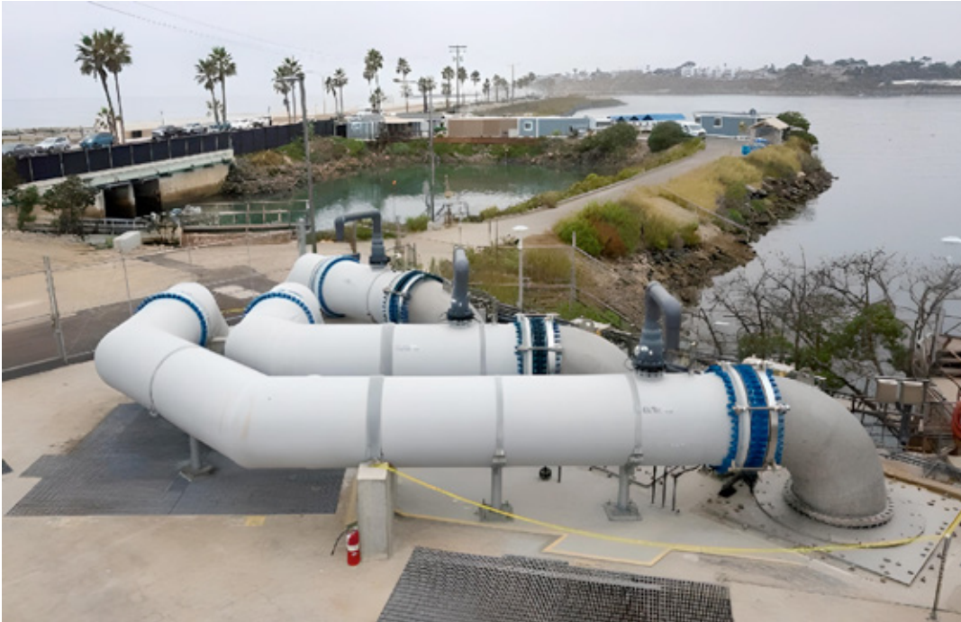
Foto 1 - Tre nuove pompe di aspirazione a ridotto impatto ambientale, presso l'impianto di desalinizzazione di Carlsbad.
