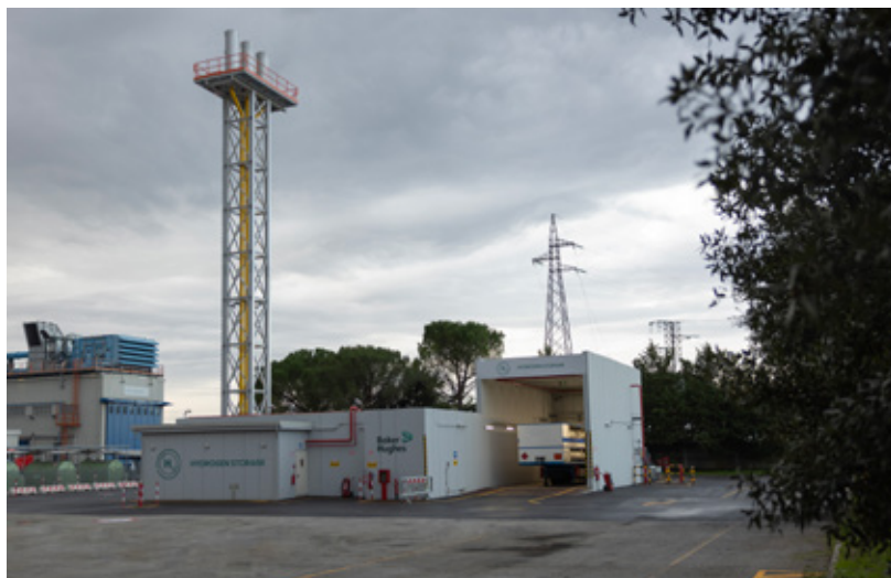
Il sistema di stoccaggio di idrogeno installato nel sito di Firenze. © 2024 Baker Hughes Company (All rights reserved)
