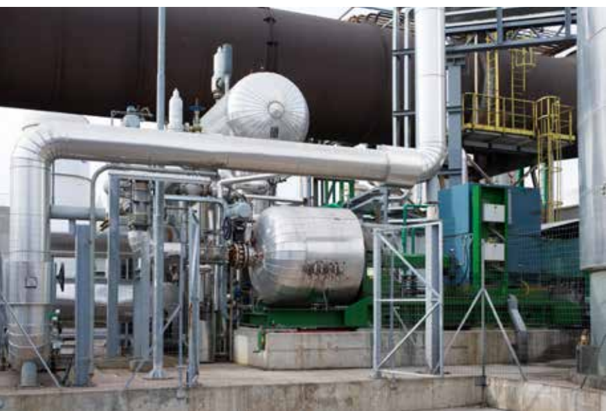
Fig. 6 – Impianto ORC per il recupero di calore nello stabilimento ABS Acciaierie, Udine, Italia
