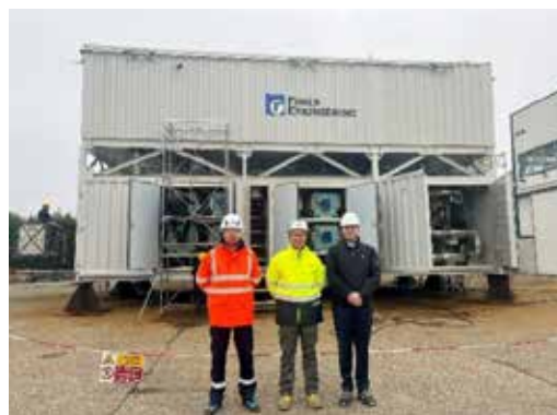
Figura 4: Elettrolizzatore in cantiere Fores
