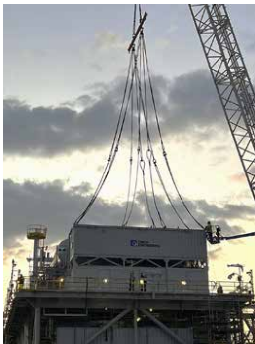
Figura 6: Posizionamento elettrolizzatore sulla piattaforma BLPH
