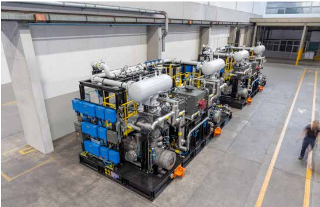
Compressore alternativo per gas di processo presso una principale società energetica italiana
