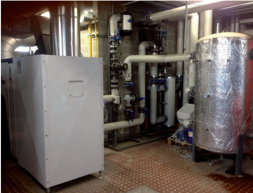
Particolare del piping meccanico e degli accumuli termici realizzati da Atet in connessione alla microturbina AE-T100NG
