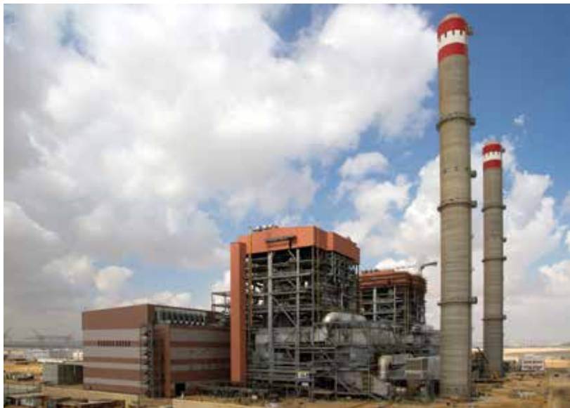
Centrale termoelettrica supercritica di El Sokhna, in Egitto
