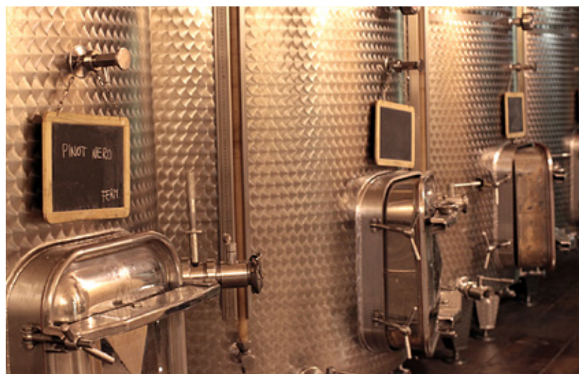
Fig. 2 – Alcune delle autoclavi che operano a 5 atm
