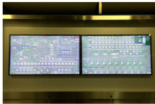
Fig. 5 – Vista parziale del pannello di supervisione del sistema di controllo
