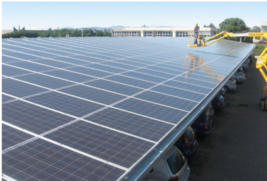
Impianto fotovoltaico Edison, installato sul parcheggio dello stabilimento Roche a Monza, Italia
