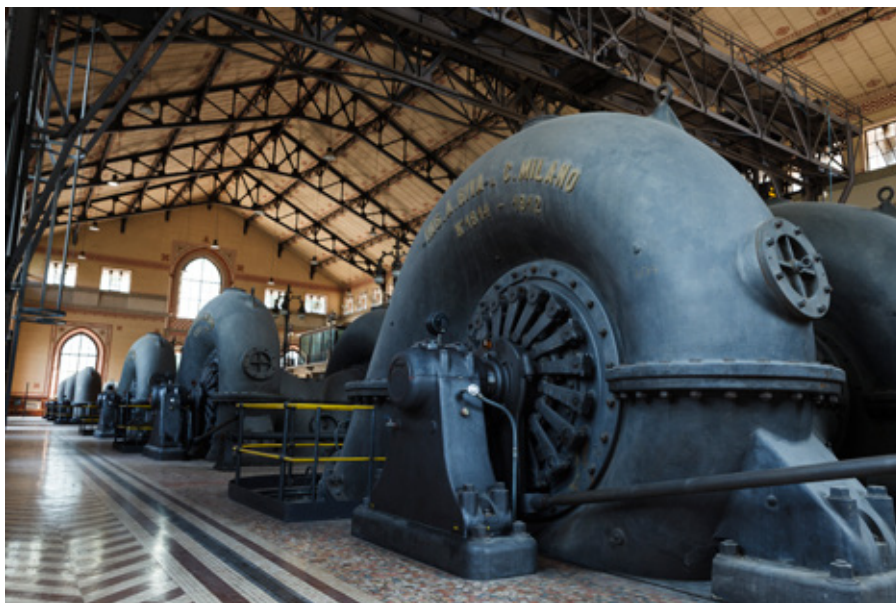
Centrale Idroelettrica "Carlo Esterle" di Edison a Cornate d'Adda, entrata in servizio nel 1914
