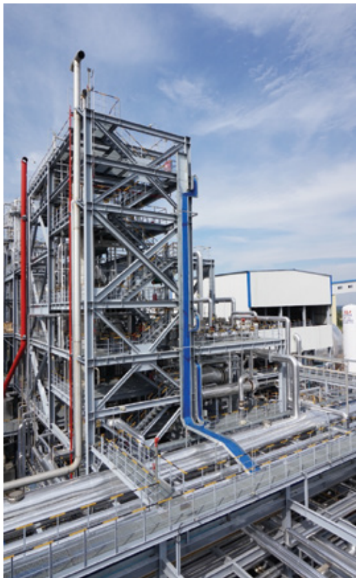
Vista laterale dell' impianto XLX Euromel® di Melammina a Xinjiang, China – Il più grande impianto al mondo a treno singolo in alta pressione, 60,000 t/a
